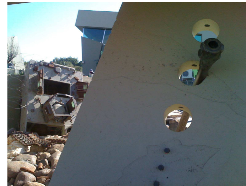
Fig. 93 - Orifícios e penetrações do concreto.
